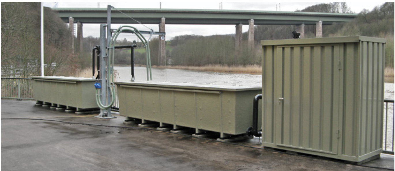
Bild 9: MIGROMAT® am Laufwasserkraftwerk Werrawerk (Foto: U. Schwevers)
